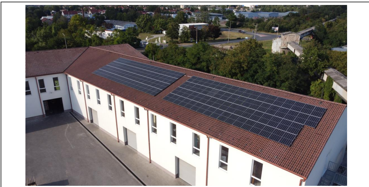
47,57 kW teljesítményű napelemes rendszer
